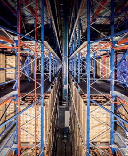
L'entrepôt automatisé le plus haut d'Europe
