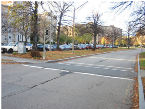
Un parkway qui nécessite une réhabilitation
