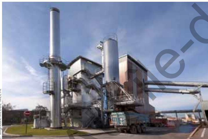
Chaufferie biomasse à Cergy (95)
