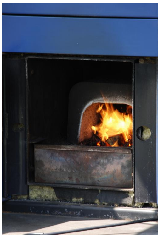
Chaudière à biocombustibles à Boigneville (91).
