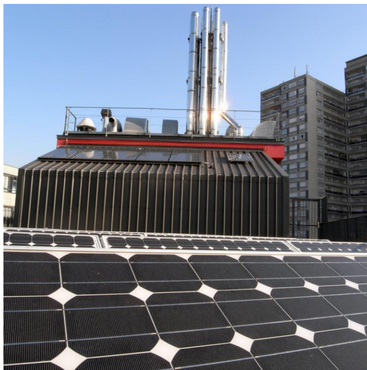
Plateau technique photovoltaïque à Alfortville (94).
