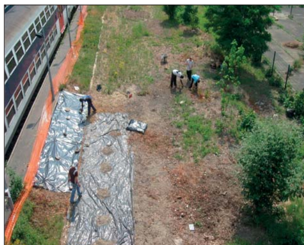
Extirpation des souches de renouées et bâchage à Pontoise. On remarque facilement que les renouées empêchent toute autre végétation de se développer.
