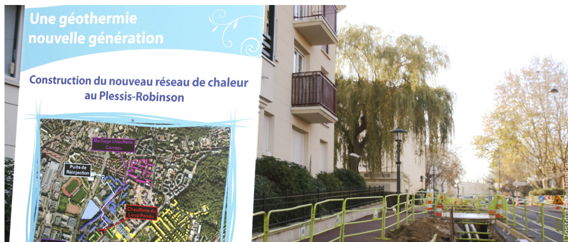
Construction du réseau de chaleur au Plessis-Robinson (92), raccordant l'habitat collectif à un chauffage par géothermie.
