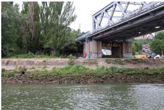
Piles de pont, contrainte ponctuelle , photo M.P-B
