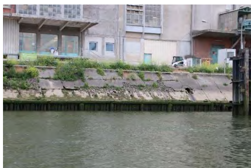
Palplanches surmontées de dalles béton dégradées sur perré maçonné, à proximité d'activités industrielles, photo M.P-B
