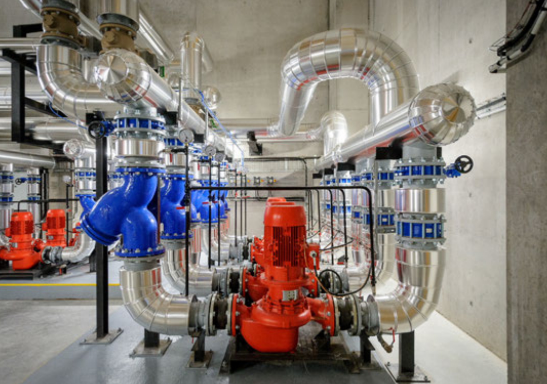
Chaufferie biomasse du réseau de chaleur de la Communauté Urbaine d'Arras © Arnaud Bouissou / Terra
