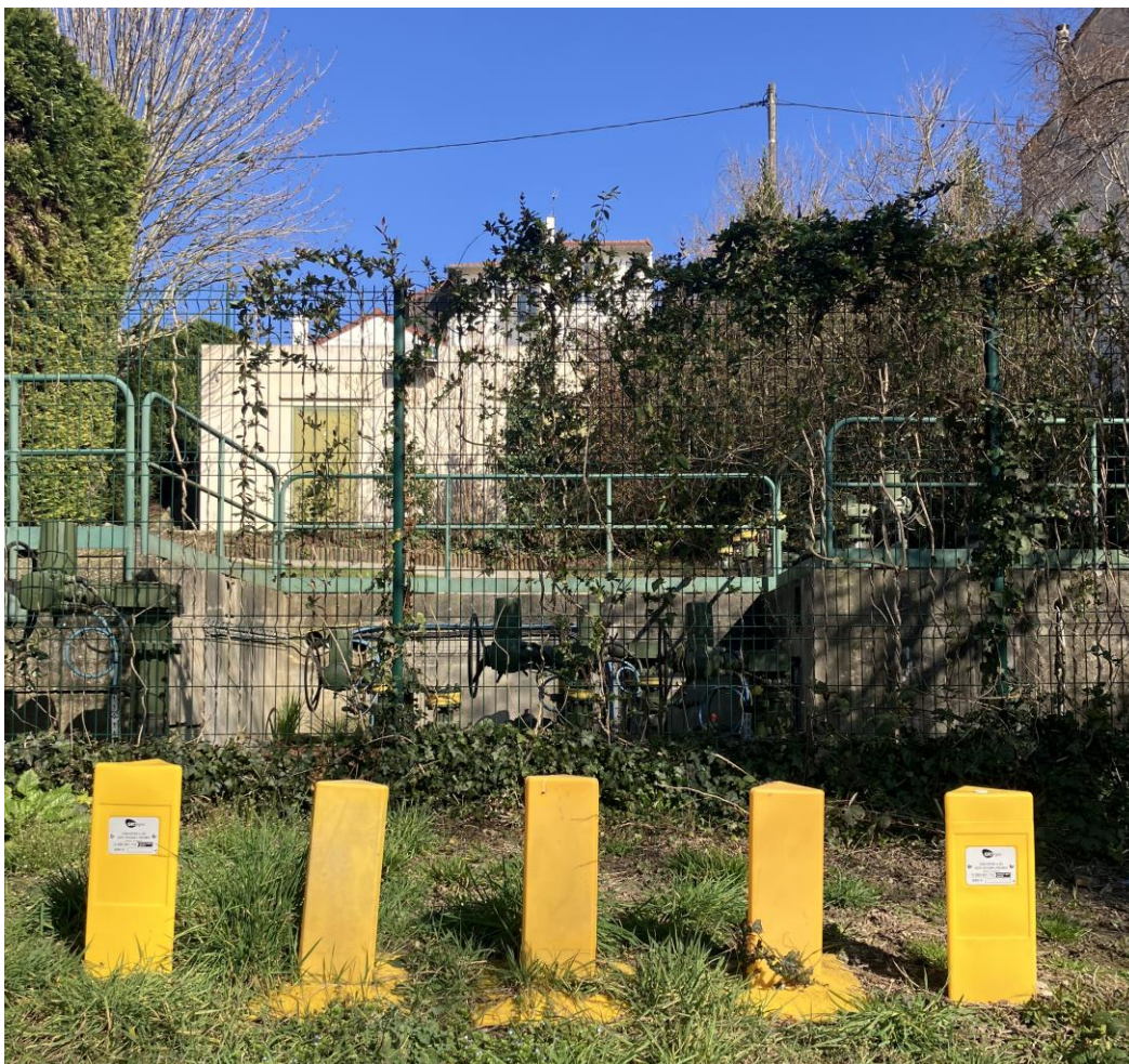
Poste gaz à Épinay-sur-Seine. Martial Vialleix/L'Institut Paris Region, 2025.
