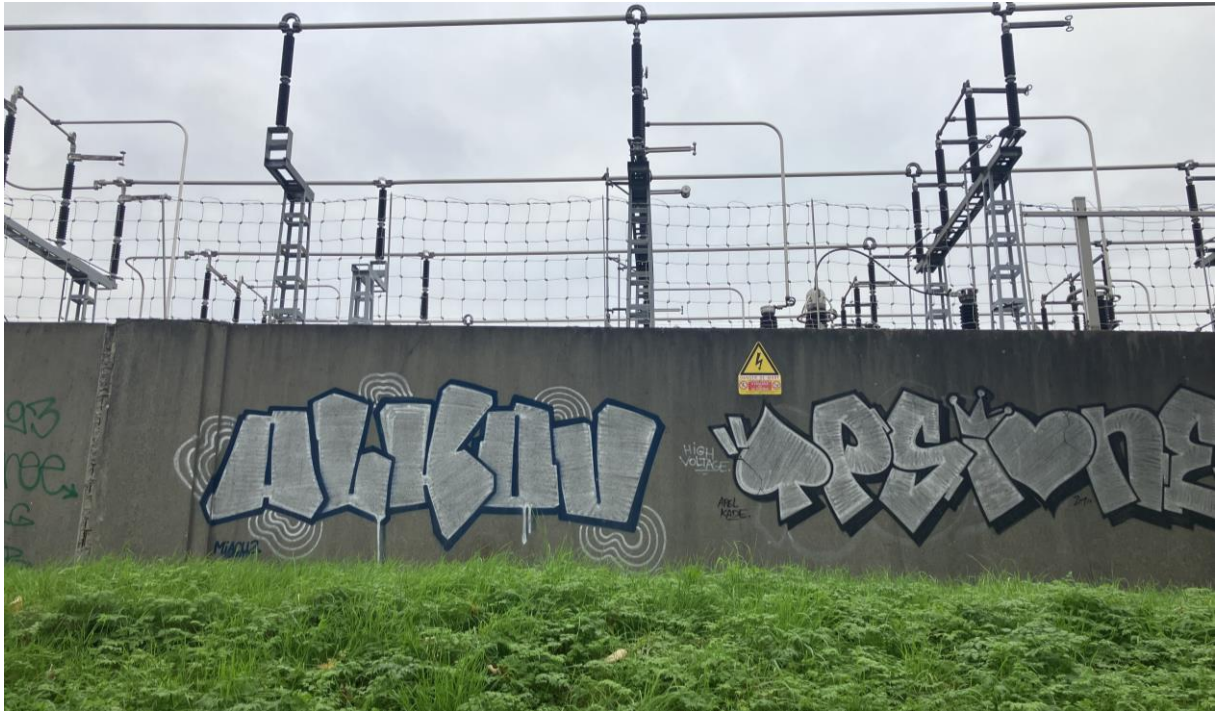
Exemple d'emprise énergétique strictement dédiée à un usage : poste de transformation à Vitry-sur-Seine. Martial Vialleix/L'Institut Paris Region, 2024.
