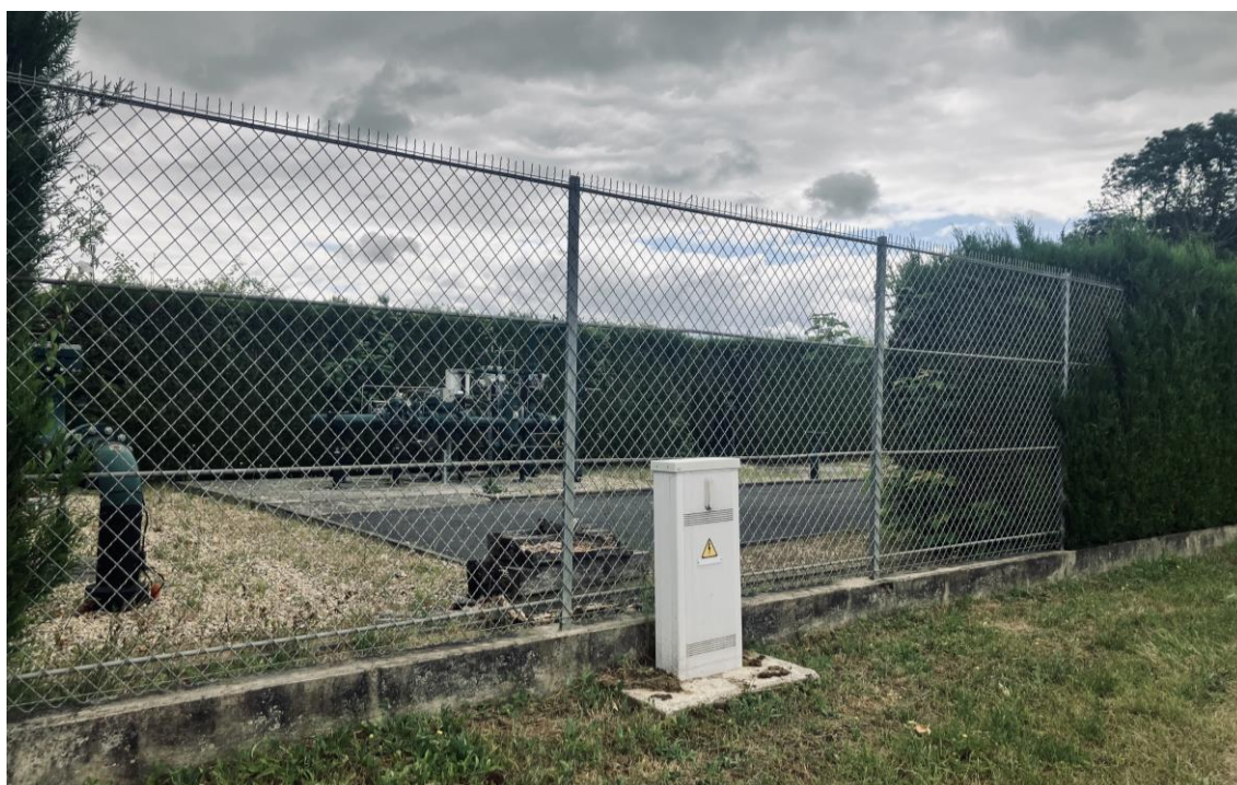
Poste gaz à Monthyon. Martial Vialleix/L'Institut Paris Region, 2025.
