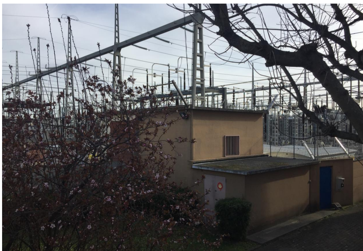
Poste de transformation électrique à Romainville. Martial Vialleix/L'Institut Paris Region, 2023.
