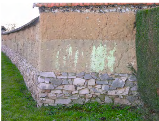
Un mur en pisé à soubassement en grès, à Mittainville – B. Cauchetier/ IAURIF
