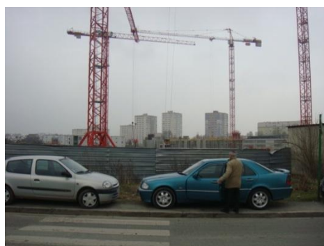
Depuis le chantier des Archives nationales, vue au loin sur le Clos Saint-Lazare. B. Guigou, IAU idF
